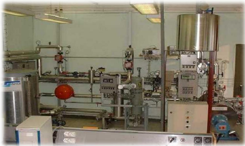
(Le générateur de vapeur de Polytech'Lille)
